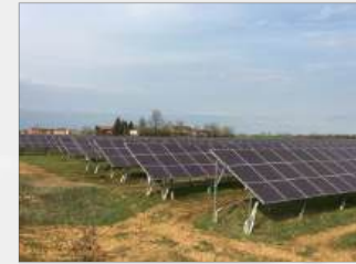
Italien Freifläche in Betrieb 2,8 MWp
