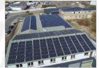
Deutschland Dachfläche in Betrieb 1.06 MWp
